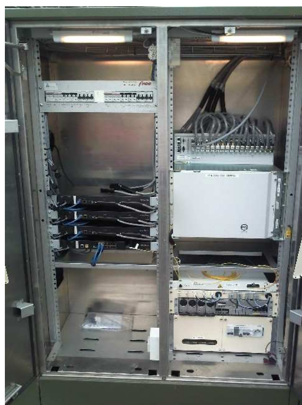
Répartiteur optique, énergie et équipements.
